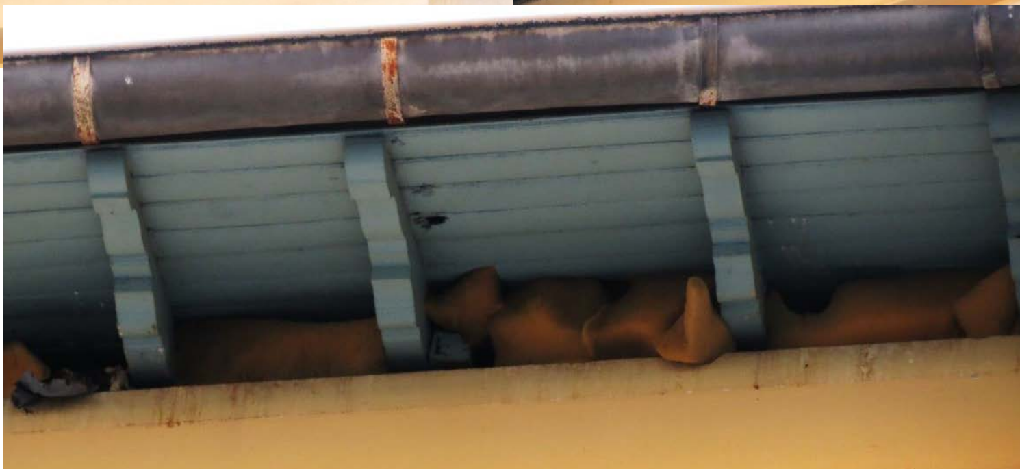
Nice : 33 rue Arson Obstruction artisanale de l'avant toit. Nous recherchons le syndic
