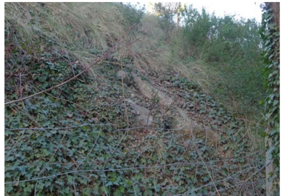
Ouvrage n°8, grillage à renforcer © LPO PACA
