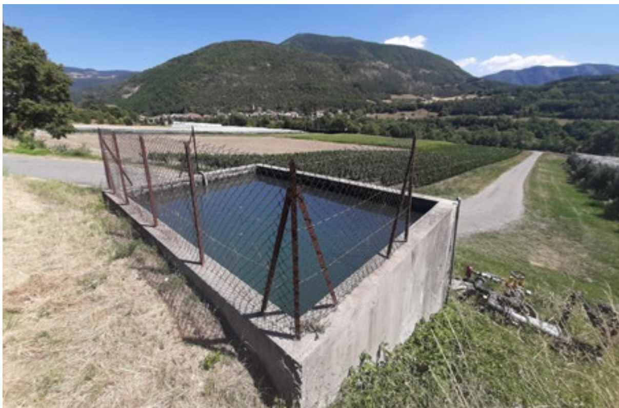
Bassin potentiellement piège à faune © LPO PACA
