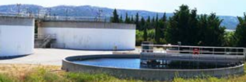
Station d'épuration des eaux usées (STEP) de Châteauneuf-les-Martigues © Éric GEORGEAULT
