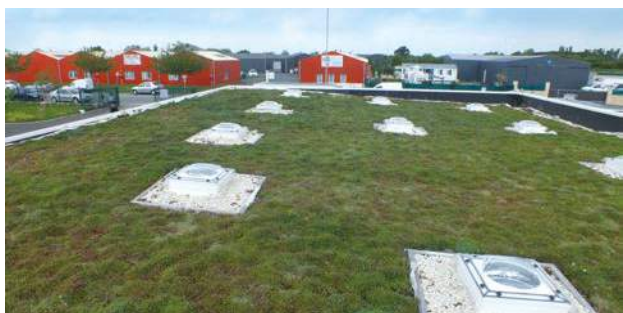
Toiture végétalisée semi-extensive (13 cm de substrat) © association d'insertion Vivractif, à Rochefort
