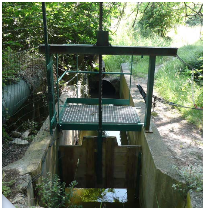
Arrivée d'eau depuis l'étang de Rassuen vers le Pourra © Micaël GENDROT
