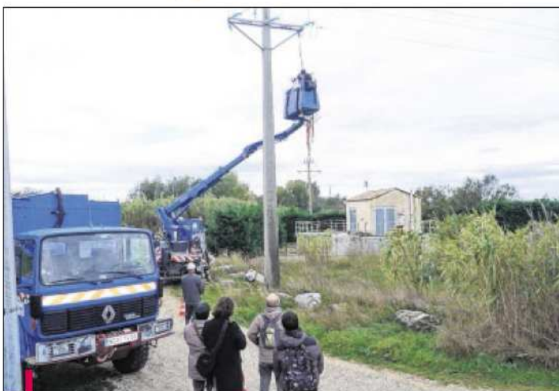
Devant les bénévoles de la LPO, les techniciens d'ERDF ont posé une protection avifaune pour permettre aux rapaces, et notamment aux aigles, de se poser sans danger.
