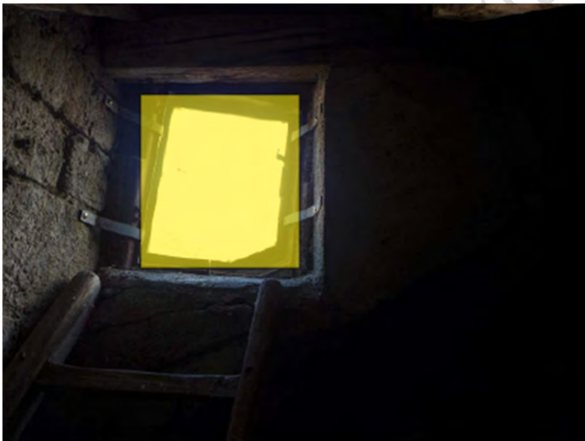
Obstruction des fenêtres aux deux extrémités des combles.
