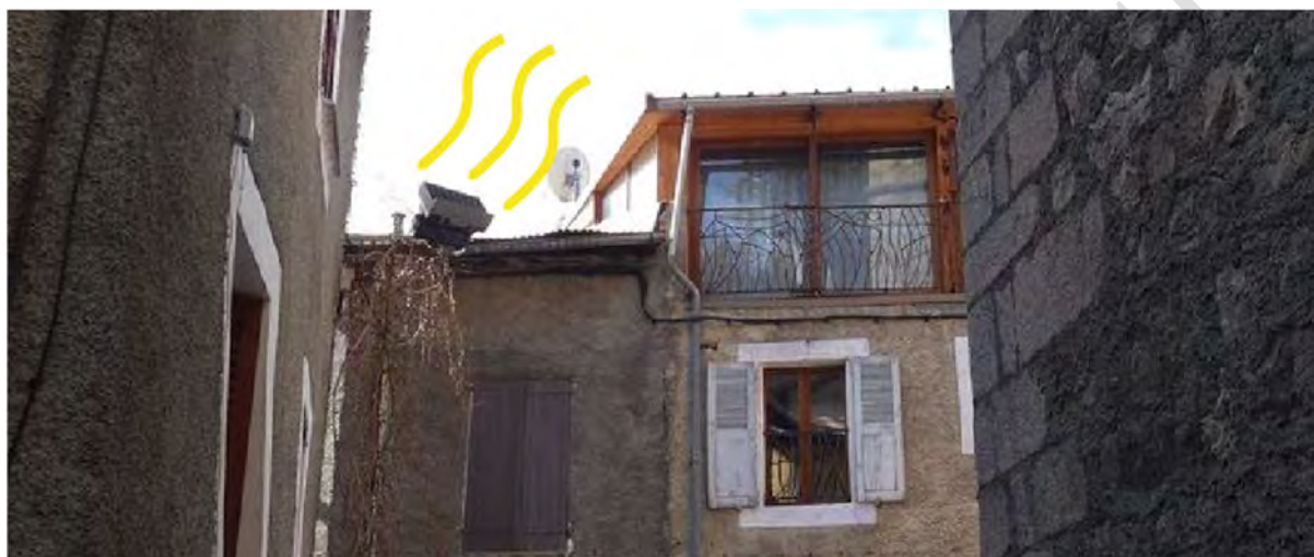
Dispositifs d'éclairage du monument en façade sud.
