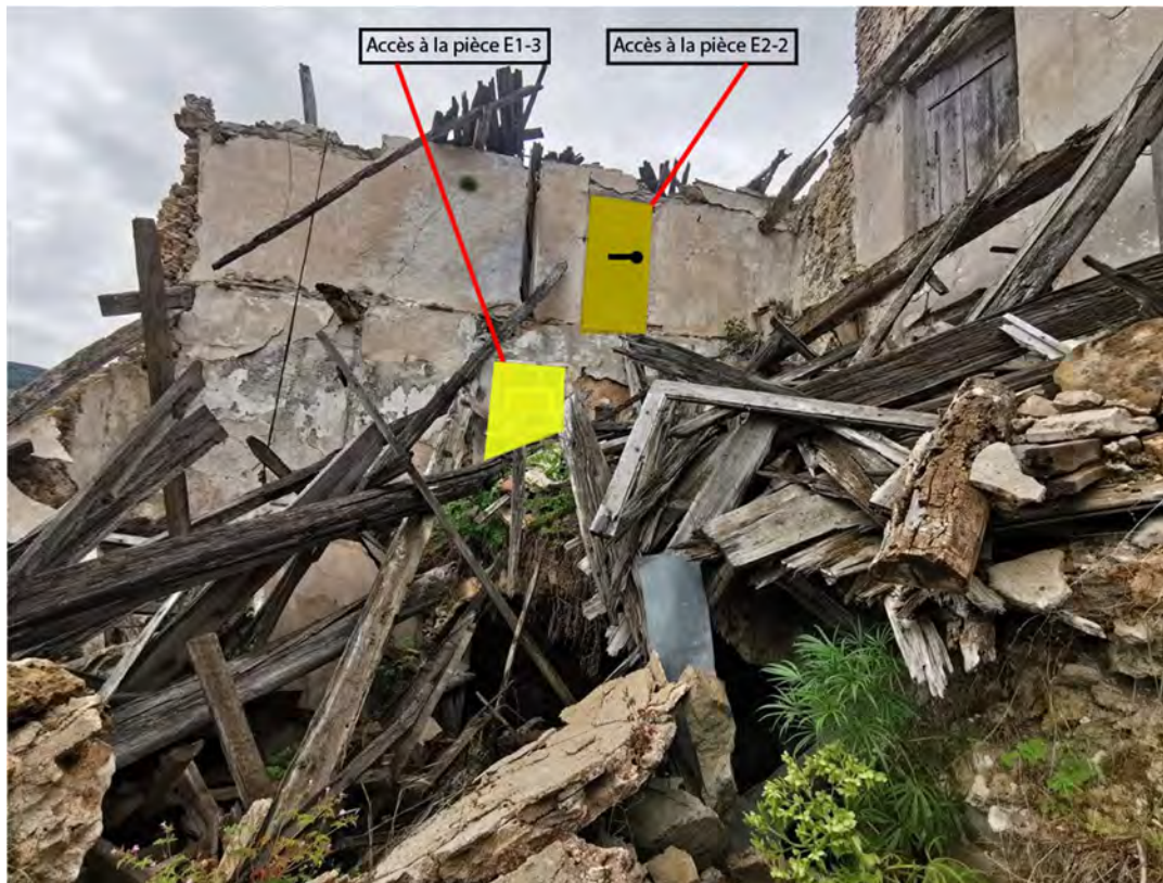
Obstruction totale de l'accès O4 vers la pièce E1-3 et pose d'une porte fermée avec cadenas au niveau de l'accès O13 de la pièce E2-2.
