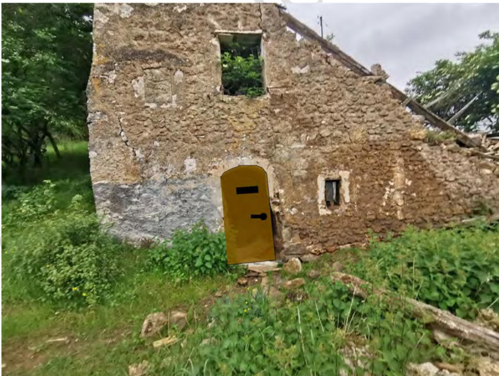
Pose d'une porte fermée avec cadenas et chiroptière au niveau de la cave du bas (RDC1).
