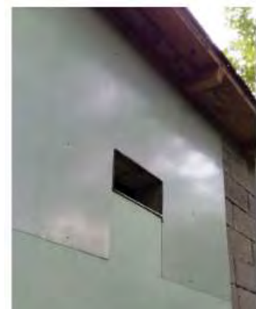
Aménagement de plaques de Zinc autour d'une chiroptière ayant permis la désertion par les Loirs (Dubourg-Savage M.J. in SFEPM 2019).
