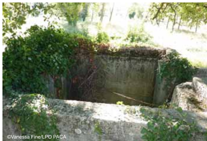
Figure 11 : « Puits » à recouvrir d'une grille
